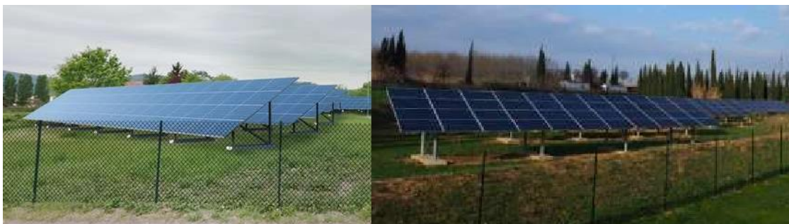
Figure 6 : Exemple d'implantation de centrales solaire réalisées par RESERVOIR SUN.
